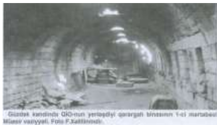
Qurd qapısında QKD-nun yerləşdiyi qoruyucu binanın 1-ci mərtəbəsi. Mənbə: vəziyyəti. Foto: F. Kəllimov.
