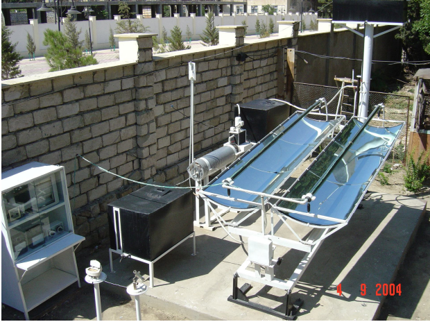
Şəkil 14.2. Parabolosilindrik konsentrotorlu günəş energetik qurğusunun ümumi görünüşü
